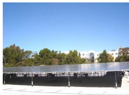
Paneles solares en el techo del sindicato IBEW Local 569, San Diego, California.
